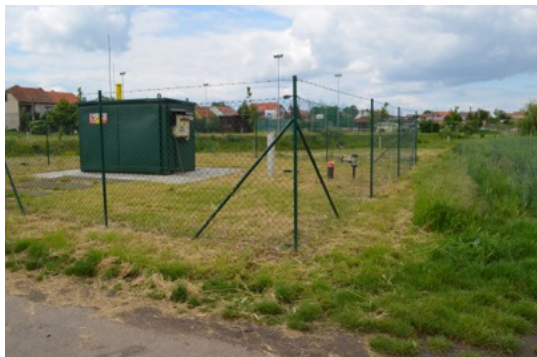
Regulační stanice VTL/NTL (jaro 2016)
